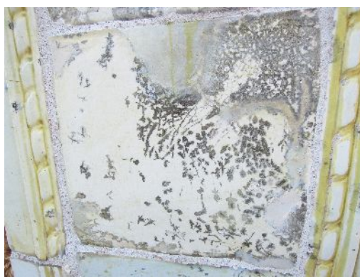
Figura 5: Degrado biologico delle vetrine delle ceramiche di rivestimento dell'Hotel Hungaria a Venezia Lido.
